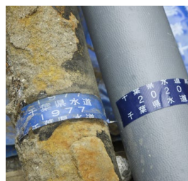
新旧の水道管
