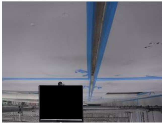
テナントビル大規模修繕工事 シール工事 外壁打継目地
