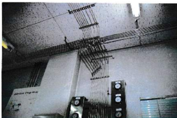
標準ガス供給設備
