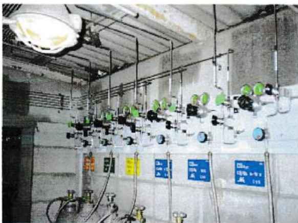
標準ガス供給設備
