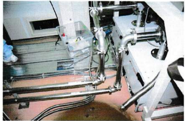
スパッタ用ガス供給設備 真空排気配管
